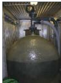
带竖管的化工品储罐 1.9m
