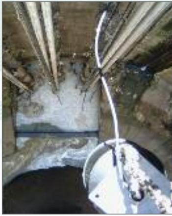
27m雨水罐 3 台泵在中心井下面
